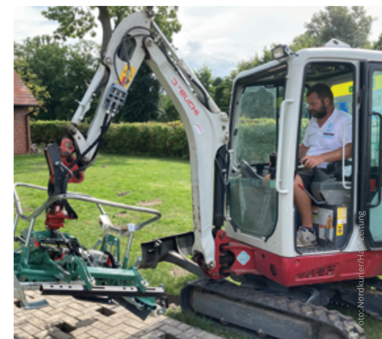
Jan Beyer bei der Sanierung des Gehweges auf dem Gelände der DGzRS-Station in Ueckermünde.
